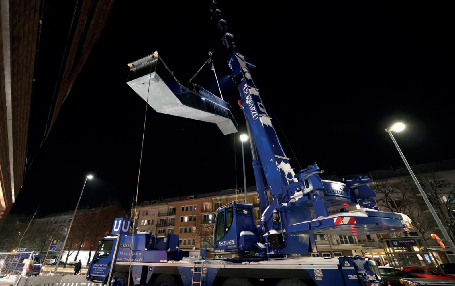
Ein beeindruckendes Bild: die „schwebende Fahrtreppe“ an der „Station Werderstraße“
