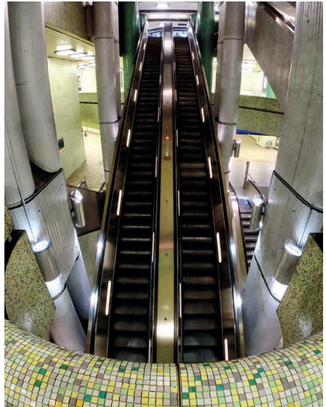
Am „Kröpcke“ wird in diesem Jahr die längste Fahrtreppe der ÜSTRA ausgetauscht.
