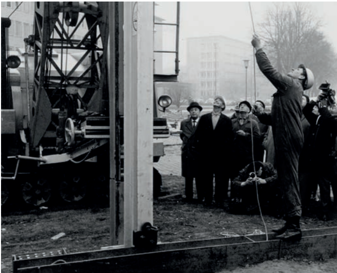
Der erste Rammschlag beim Baubeginn wurde um 10:31 Uhr ausgelöst; der Doppel-T-Träger wurde vom Bauunternehmen eigens aus diesem Anlass silbern lackiert.
