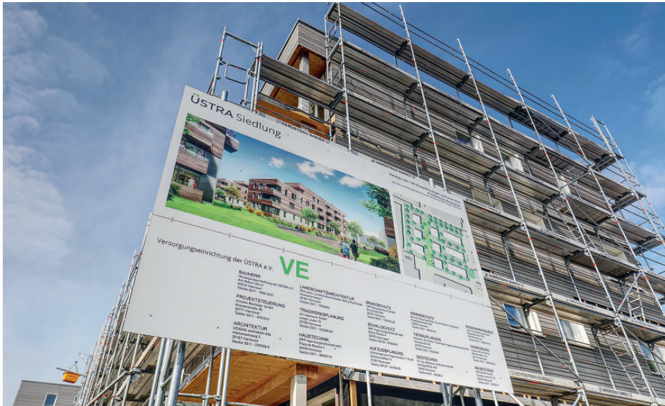
Die ÜSTRA Siedlung in der Wedelstraße ist das derzeit größte Bauvorhaben in Massivholzbauweise in Norddeutschland.
